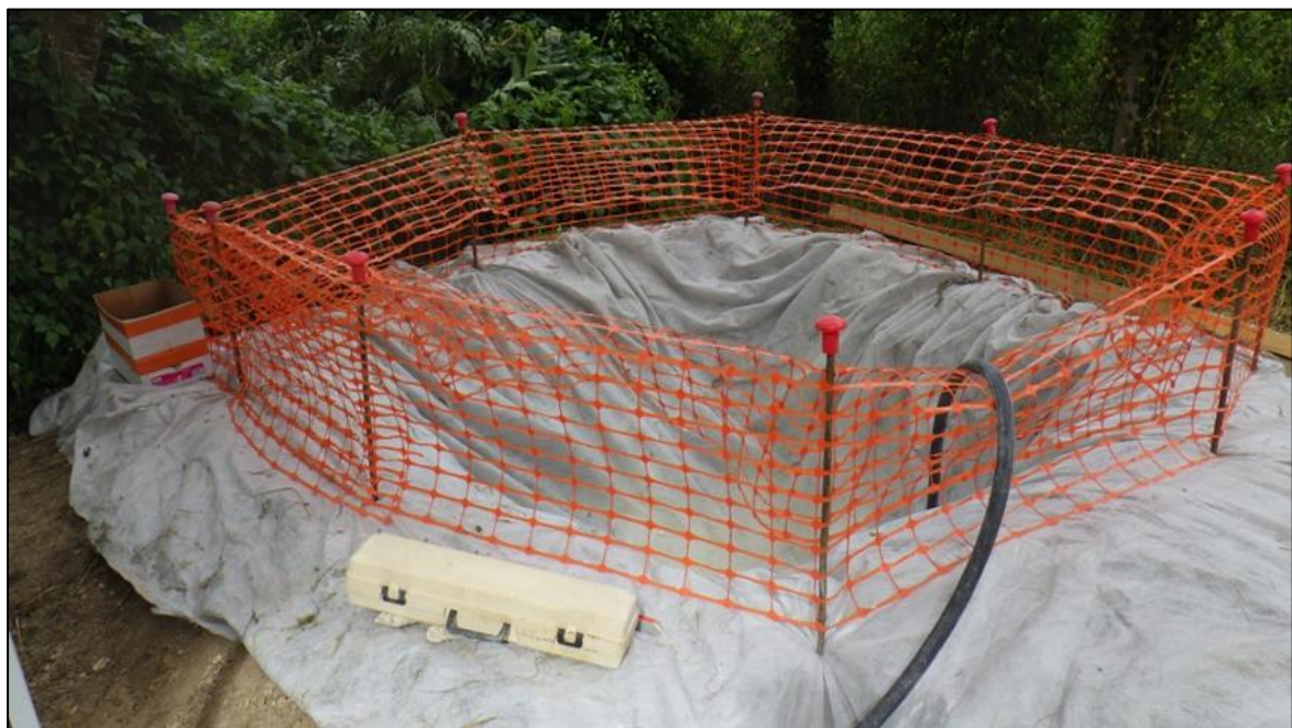
Figure 12 : Ligne 325 000 - Exemple d'un bassin de décantation provisoire pour les eaux d'exhaure de batardeaux
