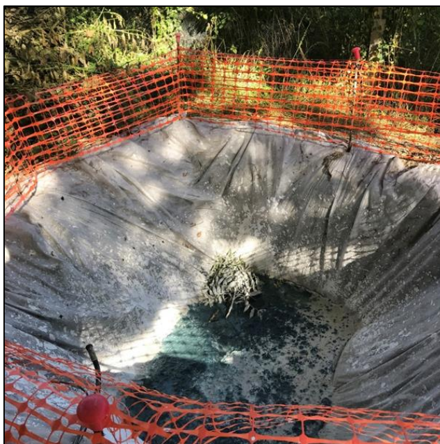
Figure 13 : Ligne 325 000 - Exemple d'un bassin de décantation provisoire pour les eaux d'exhaure de batardeaux
