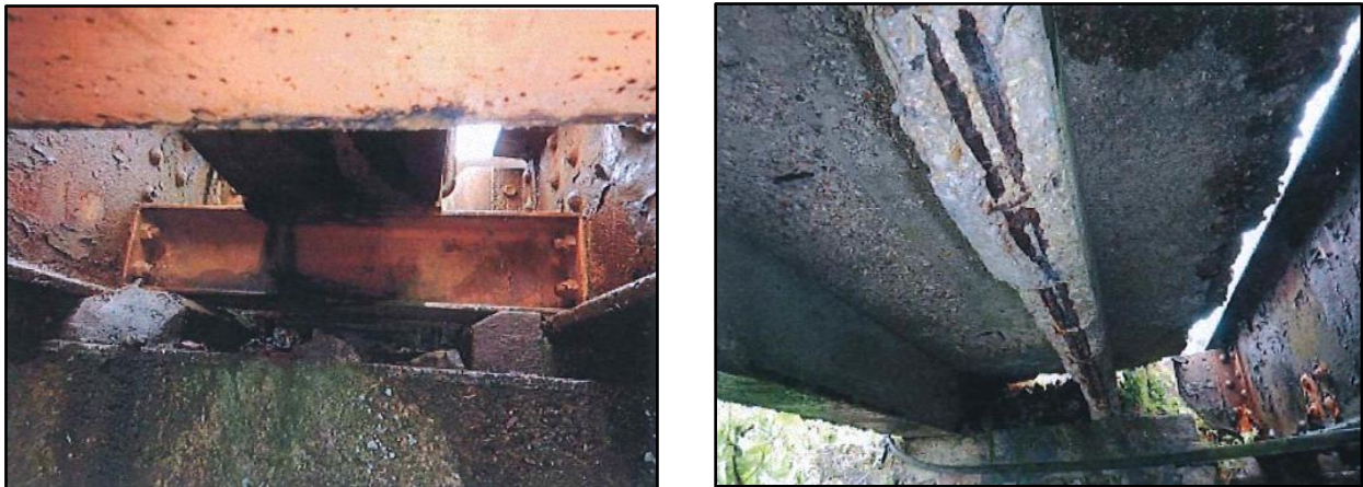
Figure 6 : Ligne 325 000 - État actuel des poutres métalliques (à gauche) et de l'accotement béton (à droite)
